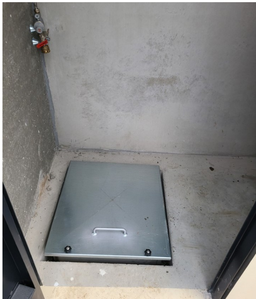
Intérieur WC sec, sans tuyauterie ni lavabo
