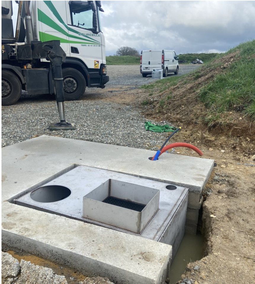
Cuve inox enterrée et bacs de récupération
